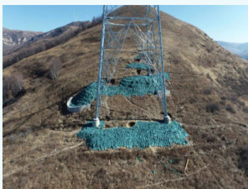
张北-雄安特高压交流输变电工程
